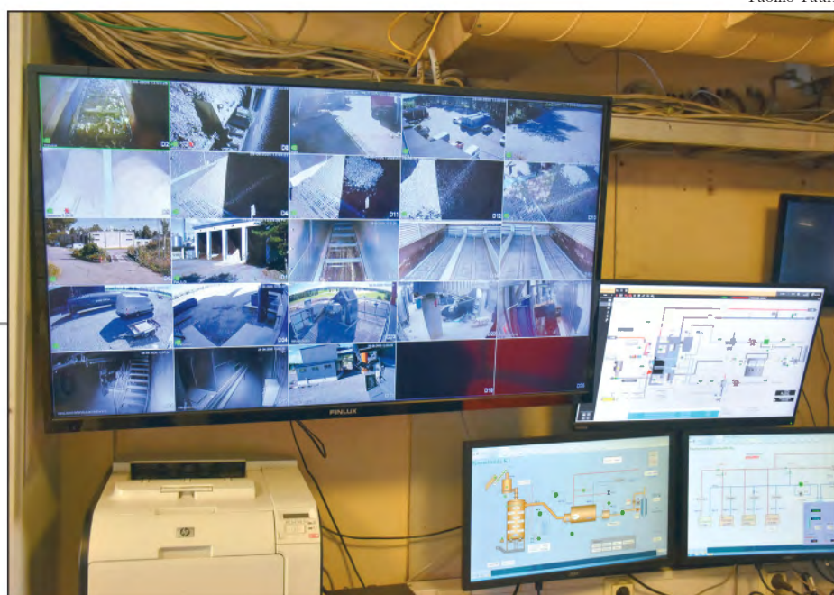
Lellavan laitoksen valvonta- ja ohjauskeskus.
